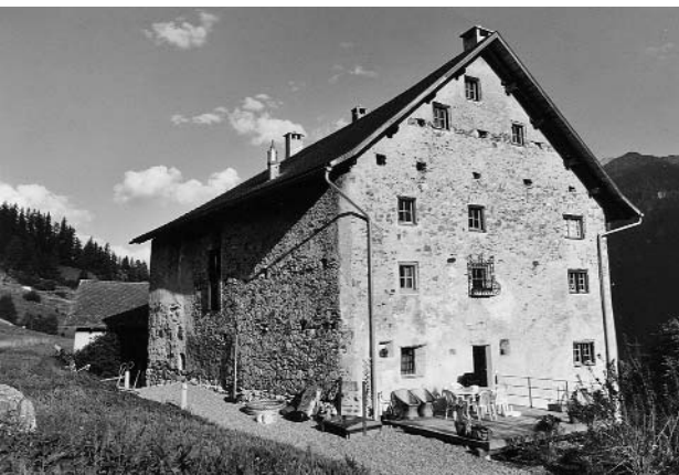
Abb. 136: Brienz/Brinzauls-Vazerol, Tgesa Gronda. Ansicht von Nordwesten. Zu sehen sind die beiden neuen Türen. Jene an der Nordfassade noch ohne Aussentreppe.
