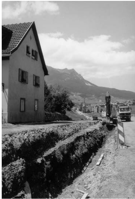
Abb. 92: Savognin, östlich Padnal. Sickerleitungsgraben im Bereich der alten Kantonsstrasse. Ansicht von Südosten.
