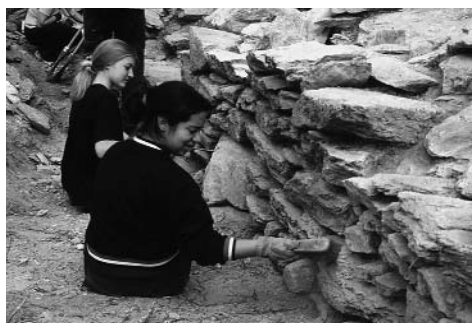
Abb. 6: Müstair, Burgruine Balcun At. Schülerinnen der Berufswahlschule Bülach ZH reinigen die erhaltenen Reste der Westmauer.
